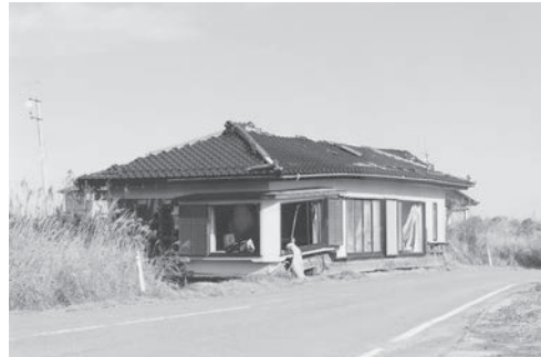
⑥道路わきにあった平屋の住宅ではないです。これも約200m先から流されて来た2F部分です。津波は無情です。持主は見たくないと云っております。
